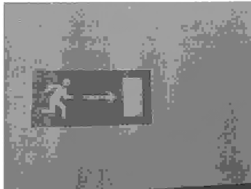
Фото №15 Визуальные средства путей эвакуации
